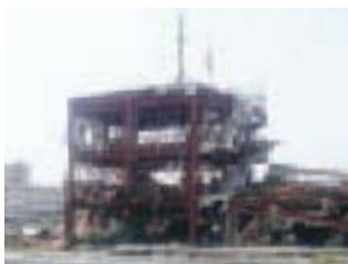
東日本大震災により被災した南三陸町防災センター
